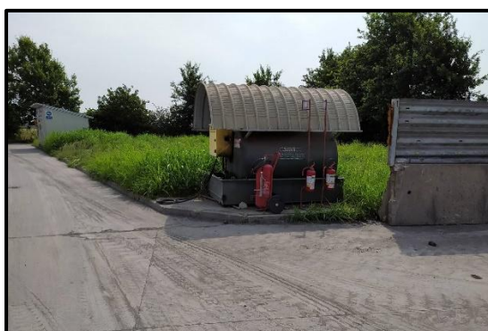
Foto di dettaglio del serbatoio di gasolio
